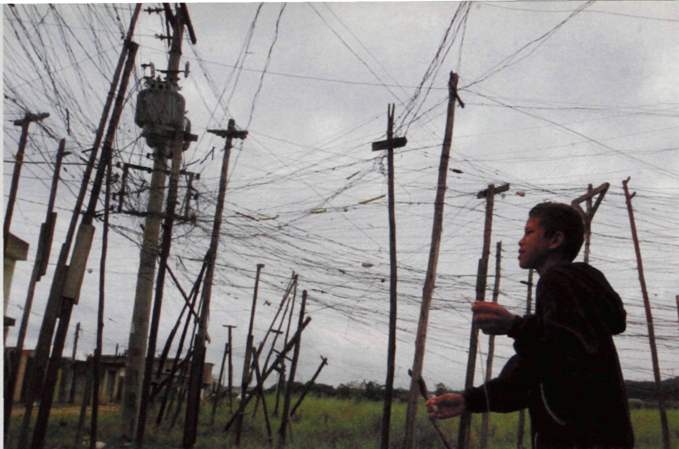
Un enfant joue sous une toile de branchements électriques illégaux, dans le bidonville de Jardim Pantanal, à Sao Paulo, le 14 mai 2001. Le Brésil est en pleine crise énergétique, avec des pannes de courant à la grandeur du pays.
